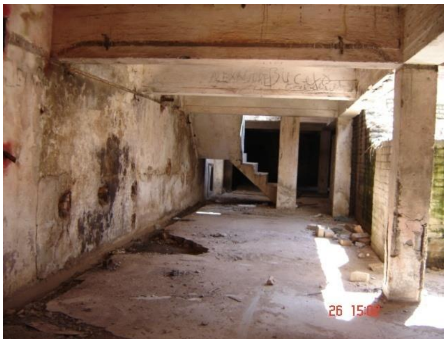
Figura 12: Vista interna da casa das caldeiras da antiga fábrica Matarazzo em 2005. Era visível o estado de degradação do imóvel industrial tombado em 1992 pelo Estado, com sérios riscos de desabamento da estrutura física. Nesse período, andarilhos e dependentes de drogas conseguiam entrar na edificação com relativa facilidade, tornando o local, além de insalubre, perigoso na questão da segurança pública, por isso, o abandono de imóveis fabris presentes no espaço urbano devem ser discutidos como prioridade dos proprietários e do poder público na resolução desse polêmico tema. Autor: Rodrigo Modesto Nascimento, 2005.
