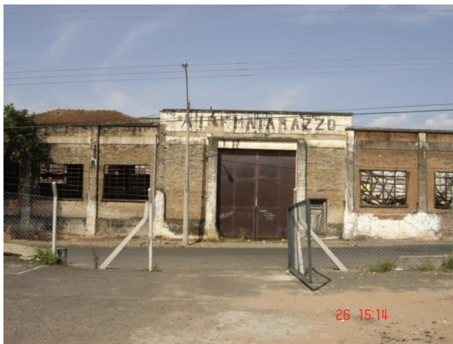
Figura 16: Portal da indústria Matarazzo, em péssimas condições de conservação e, em estado de abandono, no ano de 2005. Fotografia tirada do estacionamento para veículos da casa de caldeiras, antigo uso do patrimônio industrial tombado, antes da reforma, de 2010. Autor: Rodrigo Modesto Nascimento, 2005.
